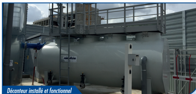
Décanteur installé et fonctionnel
