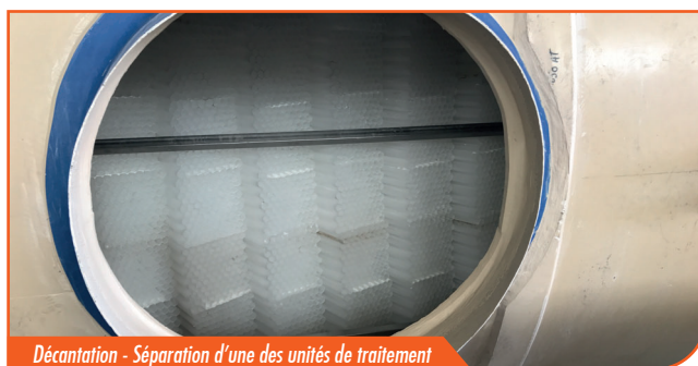
Décantation - Séparation d'une des unités de traitement
