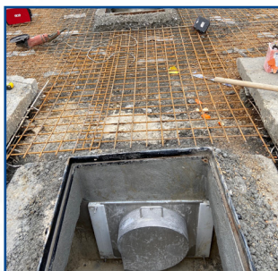
Aire Est - Limiteur vortex amont
