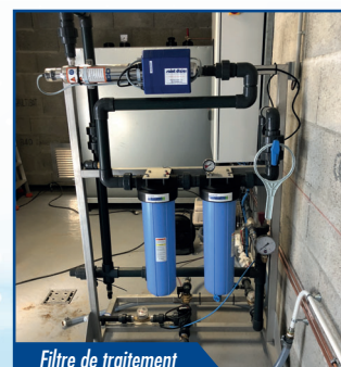
Filtre de traitement
