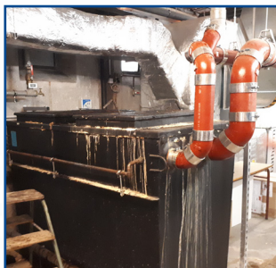
Vue du séparateur avant remplacement
