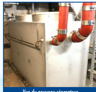
Vue du nouveau séparateur après le montage sur site
