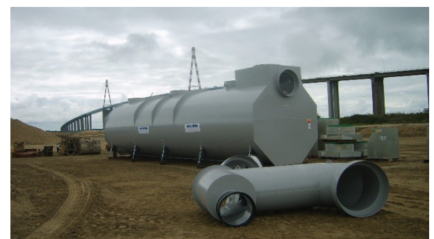
Vue du décanteur et sa conduite de by-pass en acier revêtu
